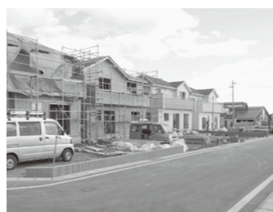
住宅が次々と建築されている 駅東第1土地区画整理事業（第1工区）
