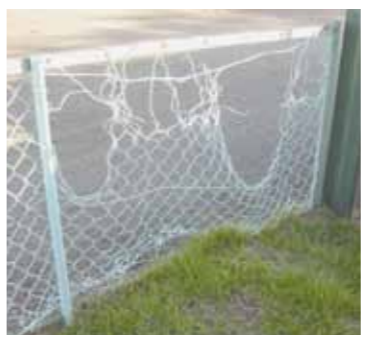
フェンス金網の落下状況
