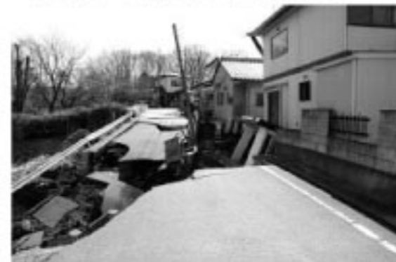
▲崖側から大きく崩落した道路（岡ノ内）
