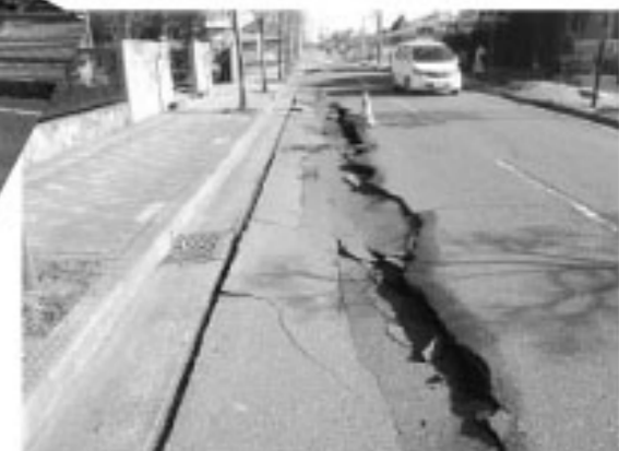
▲地震で陥没した道路が町内のいたる所で見られました。（本町）
