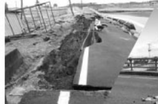
▲サカサ池付近で崩壊した道路（笠石町）
