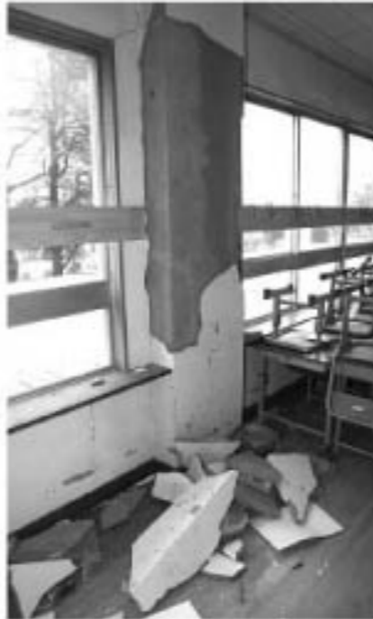
▲磐石一小の校舎も引き続き使用が困難なほどの被害
