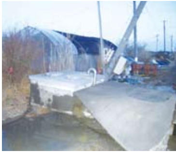
▲谷地第2分水工
