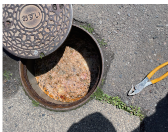
マンホールに堆積した油脂類
