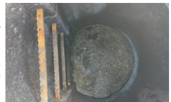
管内排水桝に堆積した油脂類
