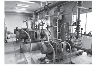
更新予定の配水ポンプ
