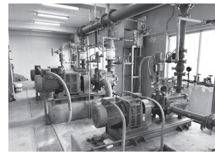
更新予定の配水ポンプ
