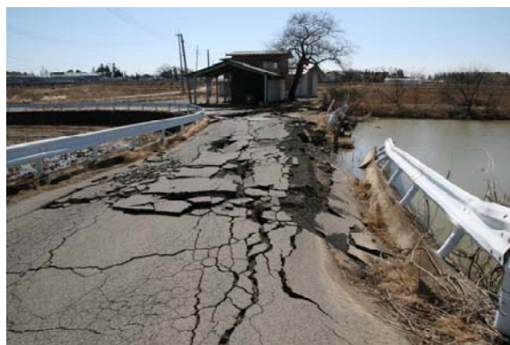
道路崩落（蒲之沢地区）
