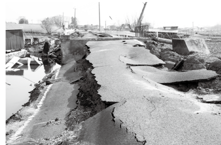
▲東日本大震災により町内全域で大きな被害(平成23年)
