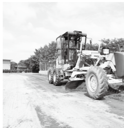
▲屋外で運動会をさせてあげたいと急ピッチで表土の入れ替え作業が進められています。(鏡石二小)
