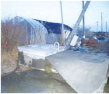
▲谷地第2分水工
