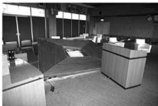
▲地震により吊り天井が落下し大破した議場
