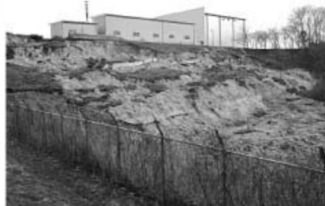
▲地形が変形するほどの約100Mの亀裂(深内)
