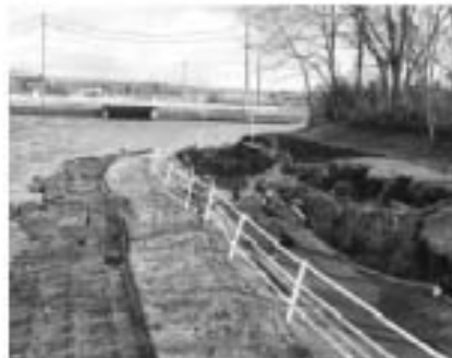
▲図書館裏の池の遊歩道が大きく崩落(梨池)
