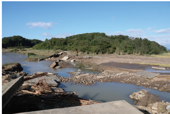
決壊した後の阿武隈川の堤防 (令和元年10月15日撮影)
