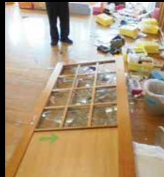
鏡石保育所では戸が倒れ、ガラスが飛び散る等の被害
