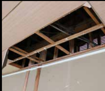
天井の一部が崩落した保健センター
