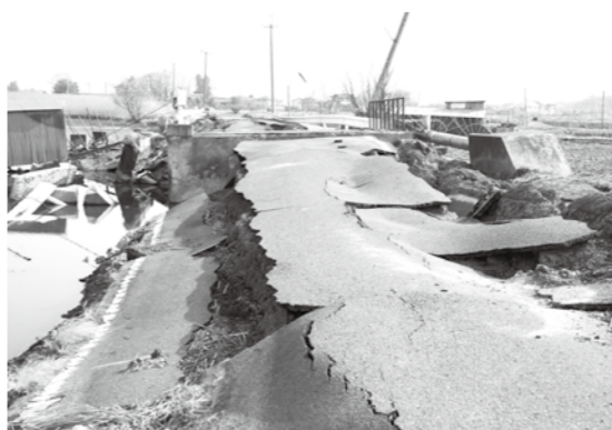
東日本大震災により被災した道路 (平成23年)
