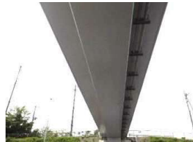
鏡石橋 :PCラーメン橋(東北道の跨道橋) ○前回点検:平成27(2015)年度実施 下部工:剥離・鉄筋露出 判定区分Ⅲ(健全度D) ○補修工事:平成29(2017)年度実施 表面被覆材塗布工、剥落防止工 ○今回点検:令和2(2020)年度実施 判定区分Ⅰ(健全度A)
