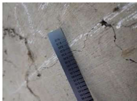
借宿橋 :鋼I桁橋 (釈迦堂川を跨ぐ長大橋) 判定区分Ⅱ(健全度C) 床版下面に最大幅0.3mmの二方向のひびわれあり。 通過車両による繰り返し荷重により、損傷は進行する可能性あり。
