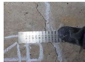
2号橋 :PC床版橋 (1級町道) 判定区分Ⅱ(健全度C) A1、A2橋台前面に最大幅0.4mmの鉛直方向ひびわれあり。 部材内部への雨水の浸入により、損傷は進行する可能性あり。
