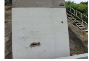
池ノ下橋 :PCラーメン橋 (東北道の跨道橋) 判定区分Ⅱ(健全度C) 橋脚(垂直材)に剥離・鉄筋露出、うきあり。 凍結防止剤に起因する塩害により、内部鋼材の腐食が進行する可能性がある。
