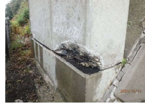
愛宕山橋 :PCラーメン橋(東北道の跨道橋) 判定区分Ⅱ(健全度C) 橋脚(垂直材)に剥離・鉄筋露出あり。 凍結防止剤に起因する塩害により、内部鋼材の腐食が進行する可能性がある。
