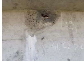
成竜橋 :PCT桁橋 (阿武隈川を跨ぐ長大橋) 判定区分Ⅱ(健全度C) ポステン桁ウェブ、上フランジ下面に剥離、鉄筋露出あり。 部材内部への雨水の浸入により、内部鋼材の腐食が進行する可能性がある。
