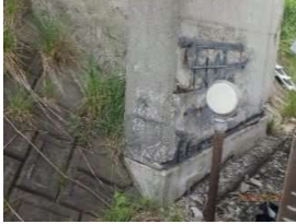
館越橋 :PCラーメン橋 (東北道の跨道橋) 判定区分Ⅲ(健全度D) 橋脚(垂直材)に剥離・鉄筋露出、うきあり。 凍結防止剤に起因する塩害により、内部鋼材の腐食が進行する可能性が高い。 ※令和6年度補修工事予定。
